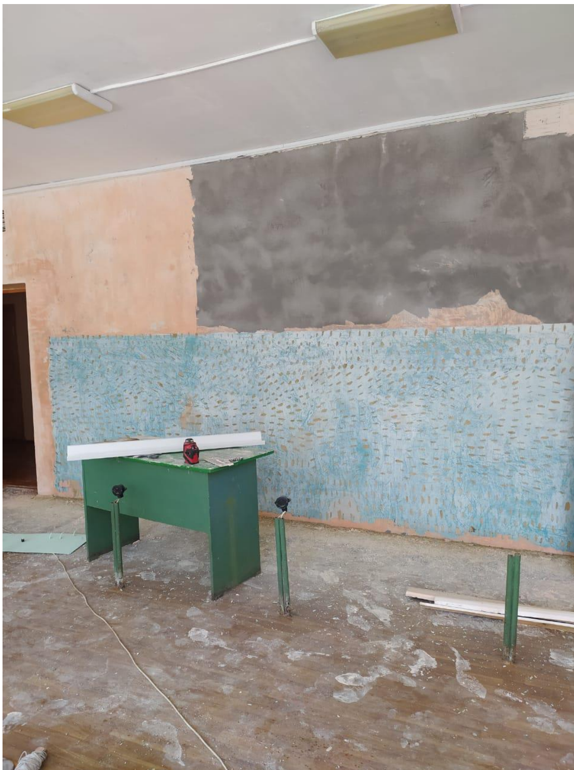
Кабинет физики до ремонта:
